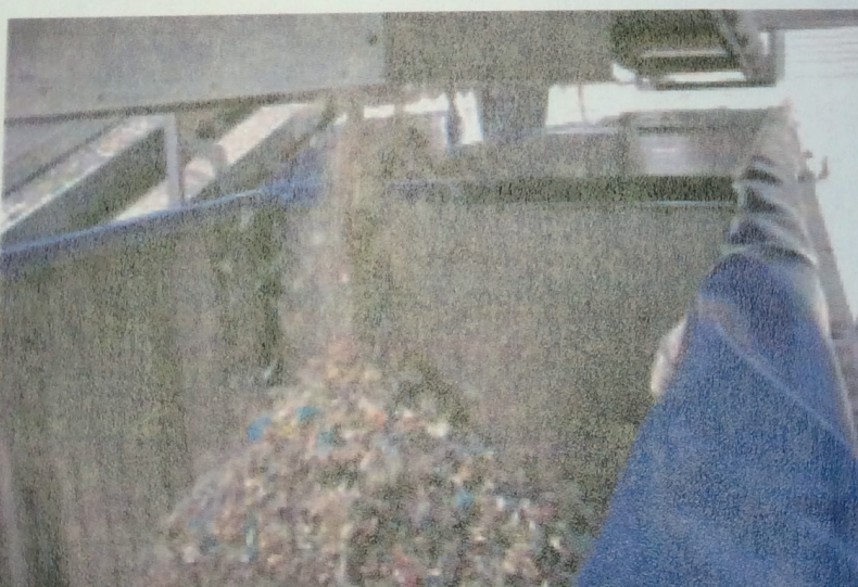
La ligne de production Coris de Péna est installée sous un hangar dont la hauteur s'élève à 13 mètres. Ceci protège les gisements et le CSR produit des intempéries. Le chargement des camions est automatisé.
